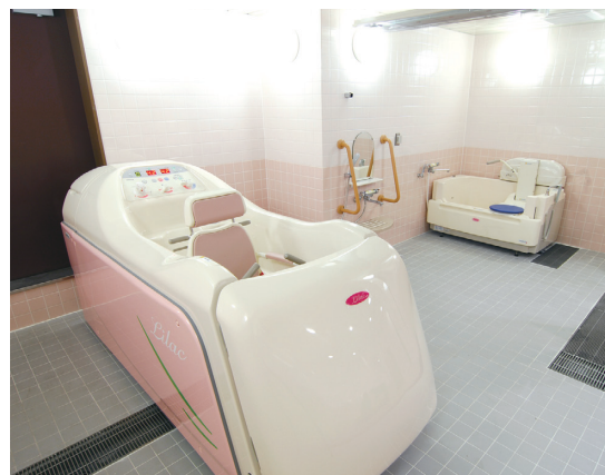
▲一階には機械浴を設置
