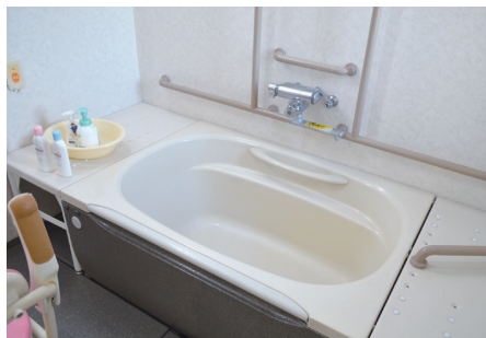
▲各フロアに設置された浴室
