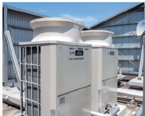
▲補助金が採択されたので高効率機種グランマルチを導入
