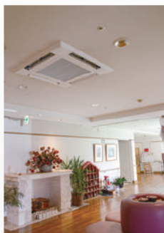
▲明るい雰囲気のエントランスロビーには、4方向の天井カセット形
