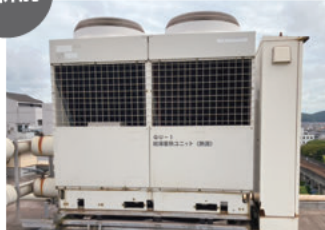
▲空冷式ヒートポンプチラー (加熱専用機) CAH-500BQ-Hx1台
